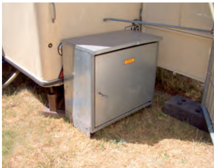
Abb. 4: Verschließbarer Flaschenschrank mit Lüftungsöffnungen und Schlüssel
